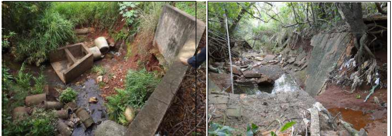
Dissipador de energia córrego Verdade
